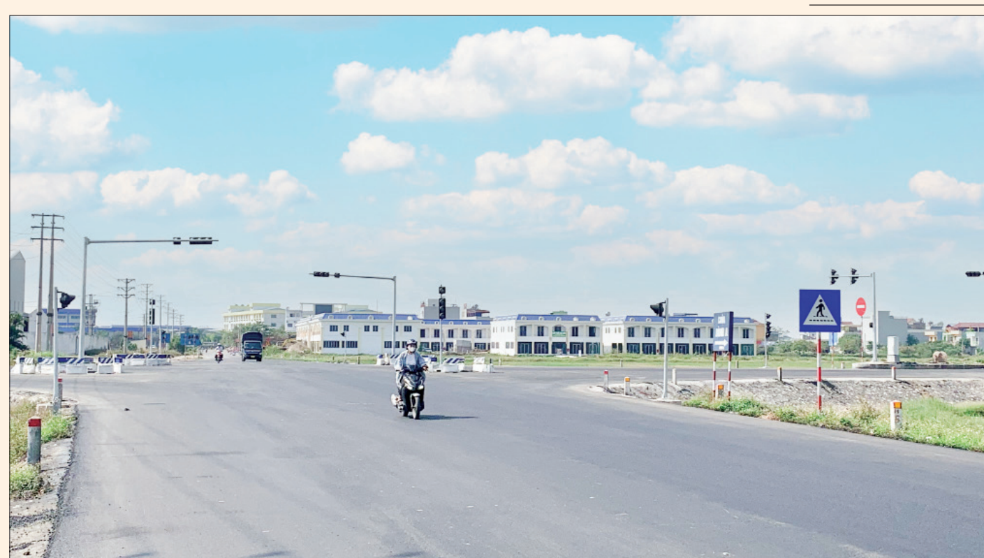
Tuyến đường cao tốc nối trục kinh tế biển qua xã Đồng Thịnh (Nghĩa Hưng) đang trong giai đoạn hoàn thiện.
