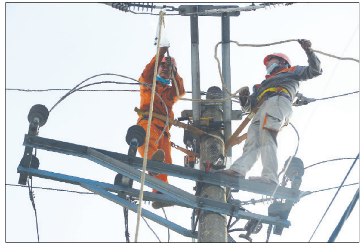
Công ty Điện lực Nam Định đầu tư nâng cấp hệ thống điện tại khu vực làng nghề Quang Trung.
