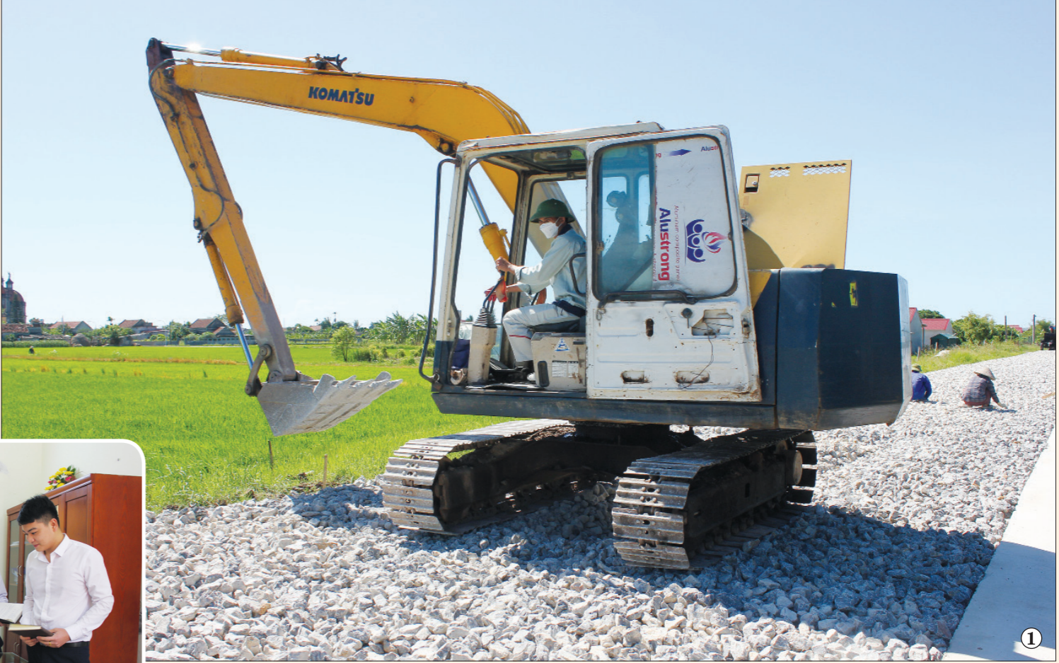
Thi công dự án cải tạo, nâng cấp đường Thành - Lợi giai đoạn III (ảnh 1); Cán bộ Ban Quản lý Dự án đầu tư xây dựng huyện Nghĩa Hưng nghiên cứu các quy hoạch để tham mưu cho UBND huyện triển khai các dự án đầu tư năm 2023 (ảnh 2).
